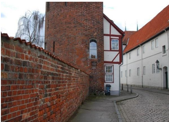
Abb. 38: An der Mauer – Mittlerer Instandsetzungsbedarf
